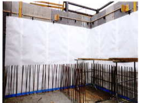
Rümlang Objekt: ACC Airport-Car Center System: Drytech Swiss Weisse Wanne Plus Realisierung: 2013
